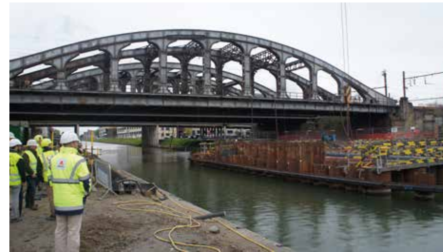
Er zal geen autoverkeer meer over de Leuvense Vaart rijden. Die auto's duiken binnenkort ondergronds, via de tunnel die de aannemers op dit moment bouwen.
